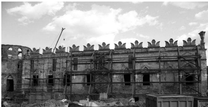
Рис. 4. Фасад палацу Сенявських із знятим тинькуванням. Хрестиками позначено місця розташування вапнякових консолей
