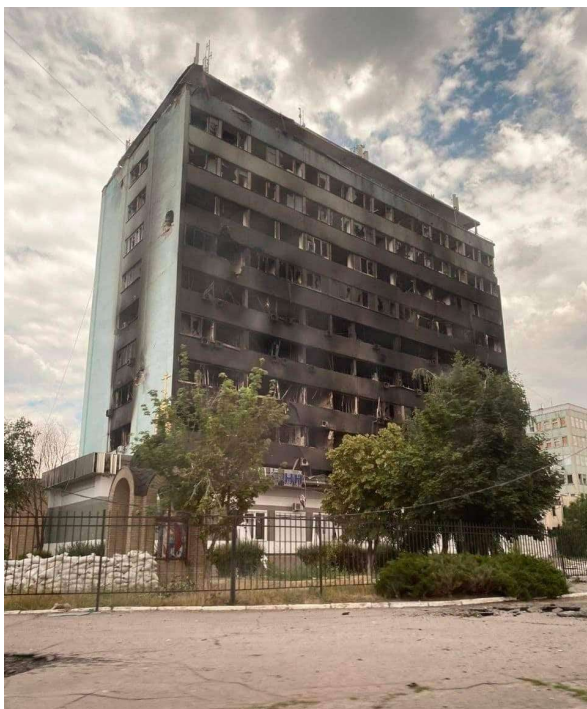
15.06.2022р. – Северодонецьк, будівля ГІАП після вибуху
