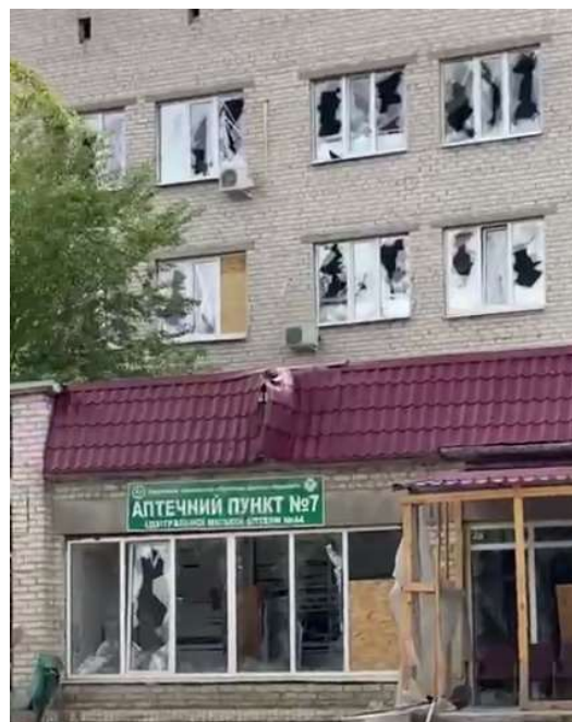
20.05.2022р. – Северодонецьк, будівля терапевтичного корпусу лікарні після обстрілу
