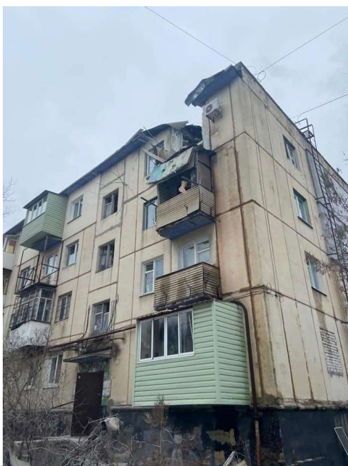
28.02.2022р. – перший суттєво пошкоджений житловий будинок Северодонецька – вул. Донецька
