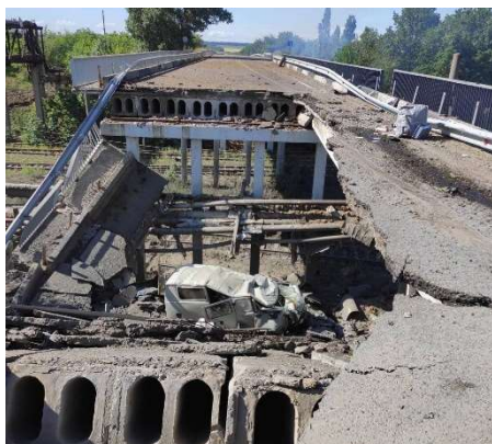
24.06.2022р. – зруйновано шляхопровід
