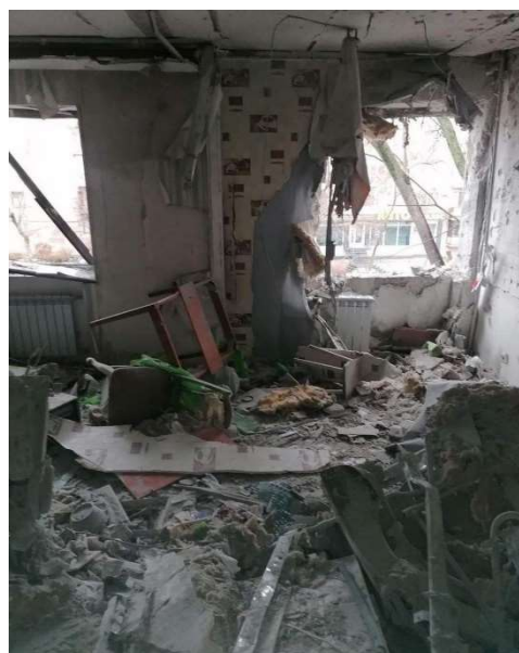
04.03.2022р. - Северодонецьк, руйнування житла
