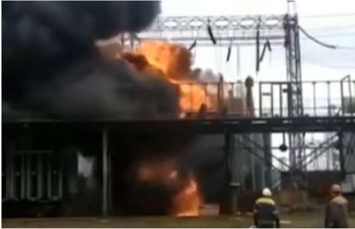
22.02.2022р. – на ДТЕК-ЛугТЕС горять трансформатори
