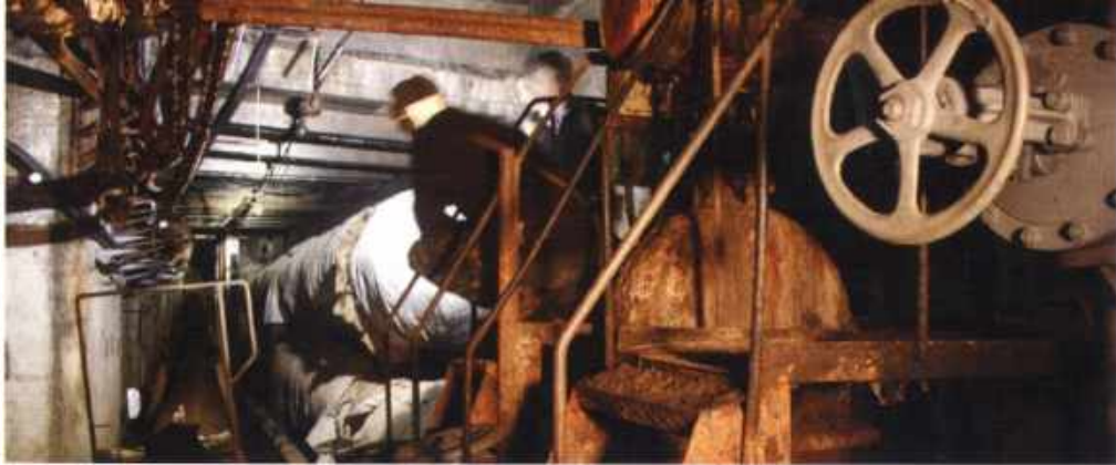
Теплотрасса «Севастопольская», Чоколовский бульвар, «Шулявская»
