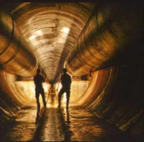
Один из подземных водопроводов в недрах Киева
