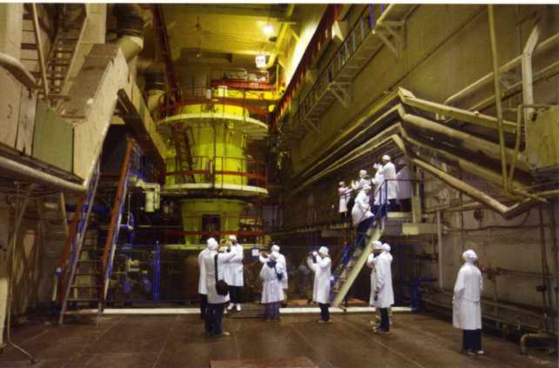
ЧАЭС, Главные циркуляционные насосы (ГЦН) 3-го реактора РБМК-1000. 3 сентября 2016 года
