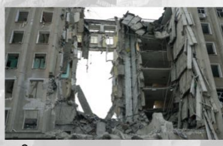
Zniszczony przez rosyjskie pociski budynek administracji powiatowej w Miasteczku, 29 marca 2022 r.
