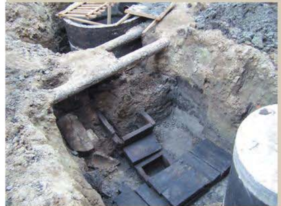
Коробчастий водогін на вул. Руській.
