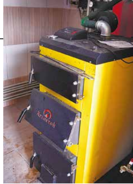
Твердопаливний котел у Дубечненському цеху переробки ДП «Старовижівське ЛГ»
