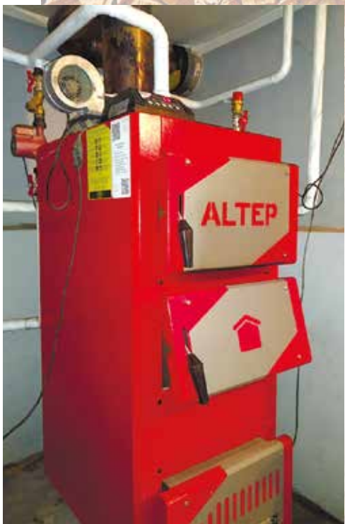
Котел для опалення виробничих приміщень у ДП «Володимир-Волинське ЛМГ»
