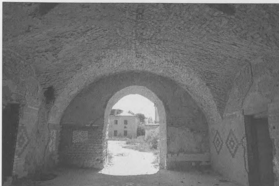
18. Klewań. Sklepienie bramyjazdowej i widok na dziedziniec, stan z 2016 r. Fot. Piotr Jamski
