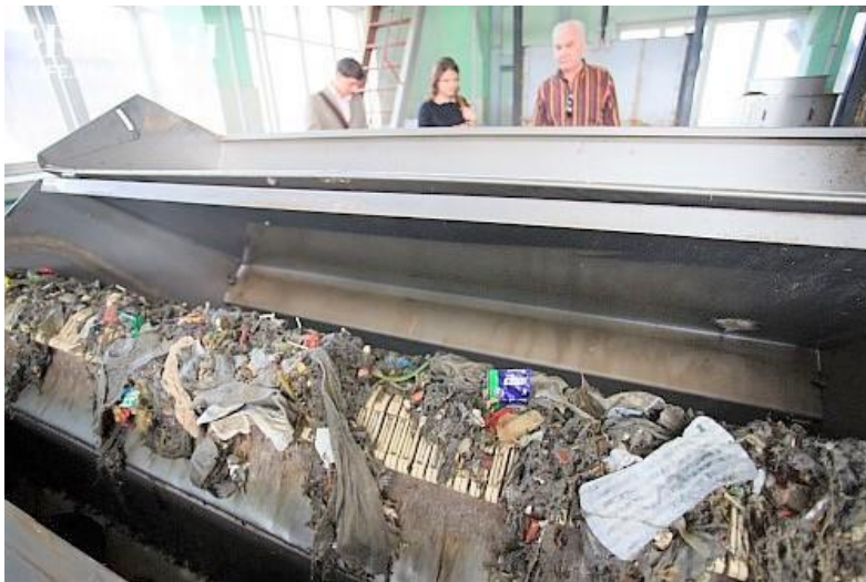
Рис. 11.9. Механічне очищення стічних вод (грабельне відділення) на Бортницькій станції аерації, м. Київ [17]
