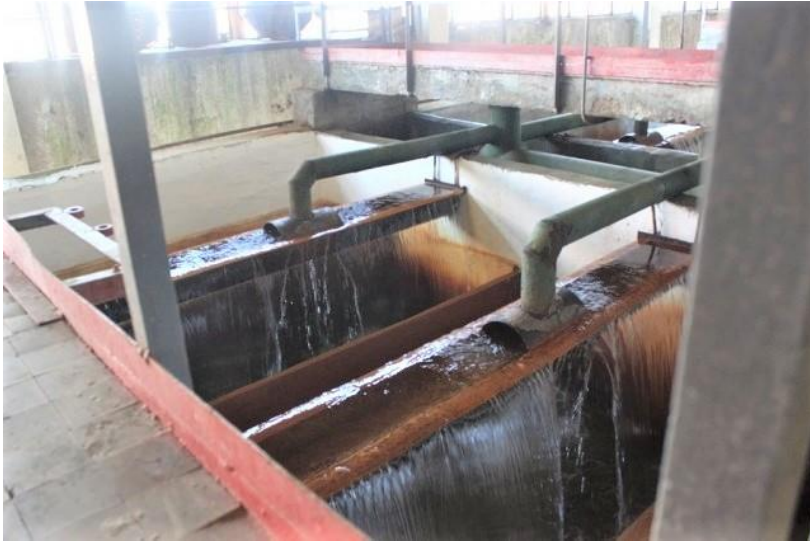
Рис. 11.12. На станції знезалізнення підземних вод КП «Луцькводоканал»
