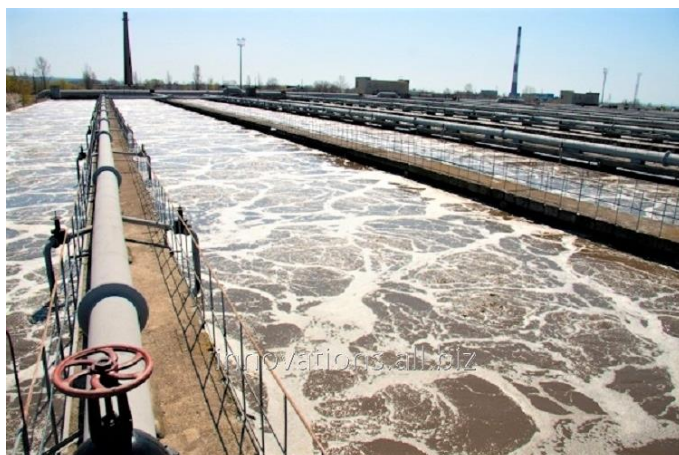
Рис. 9.3. Зовнішній вигляд аеротенка
