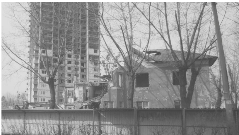
Вул. Гната Хоткевича, 8/29. Зруйновано в 2017 р.
