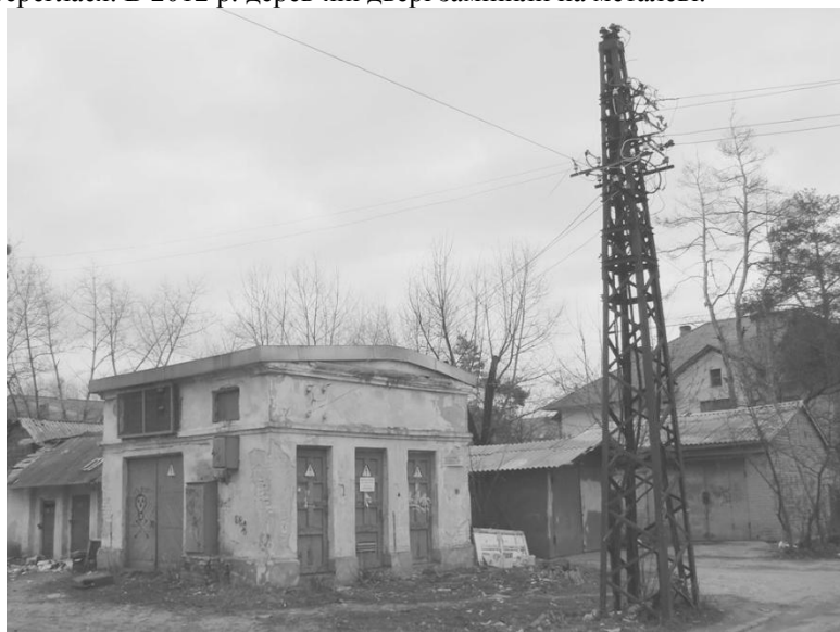
Тягова підстанція. Фото 2009 р.
