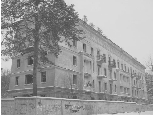
Будинок на вулиці Алма-Атинській, 115 (1936 рік). З усіх 4 довосних 4-поверхівок селища ДВРЗ чи не найкраще зберіг первісний вигляд. Будівля є давно відселеною, перебуває в аварійному стані, фото 2017 р.
