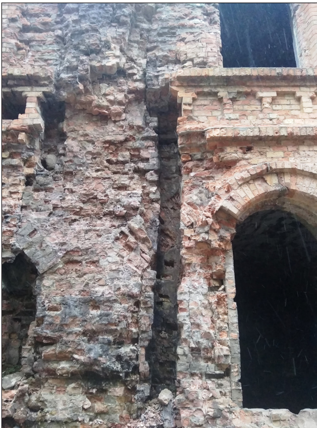
Фото 5. Зруйновані заглиблення для водозливних каналів.
