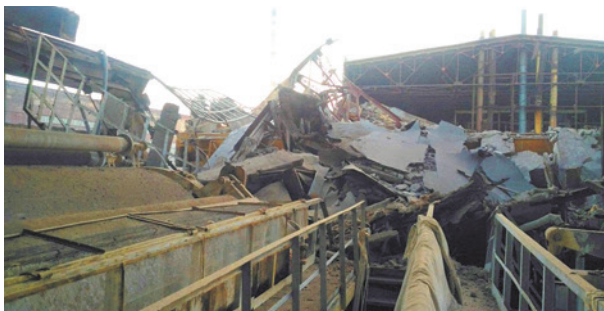
Обвал конструкций кровли площадью около 3,5 тыс. м 2 в одном из цехов предприятия «Крымский Титан» (производитель диоксида титана) в августе 2017 г.
