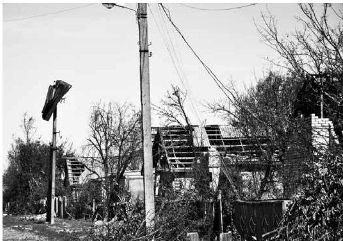
Наслідки буревію в с. Привітне
