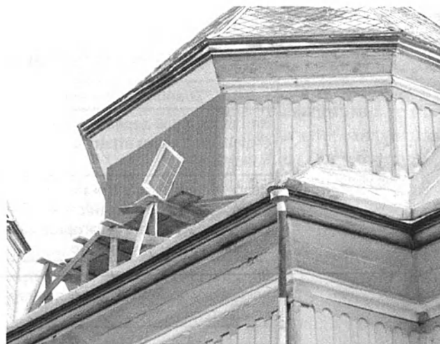
Рис. 4. Процес обшивання світлого барабану церкви Воскресіння Господнього профільованими металевими листами, с. Голишів Рівненського району. Фото П. Ричкова, липень 2016 р.
