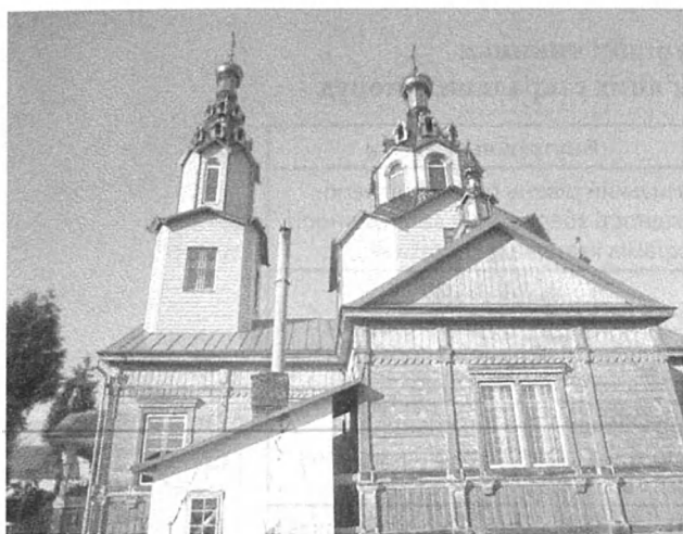
Рис. 2. Процес облицювання дерев'яного храму ПВХ-сайдингом. Церква св. Архангела Михайла. С. Нова Пляшева Радивилівського району. Фото Н. Лушнікової, липень 2016 р.
