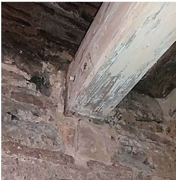
Рис. 16. Дерев'яний брус, закладений у розтесане первинне гніздо. Під дерев'яним брусом проглядає закладка нижньої розтесаної частини гнізда
