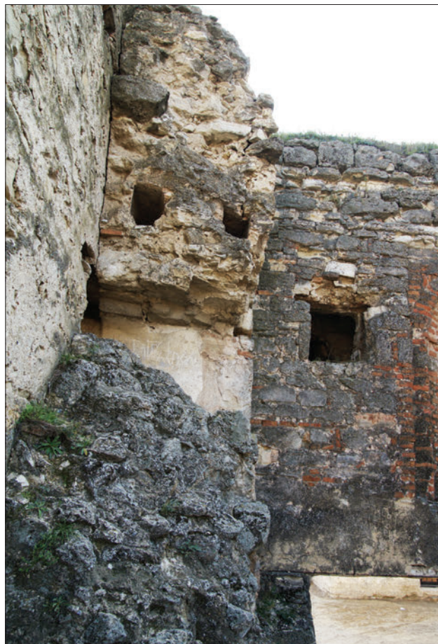
Рис. 33. Бендерська фортеця, 2008 р. Надбрамна вежа (№ 1). Стикувальний шов двох будівельних періодів: 1538 р. і 1584 р. (фото: Д. А. Топал).
