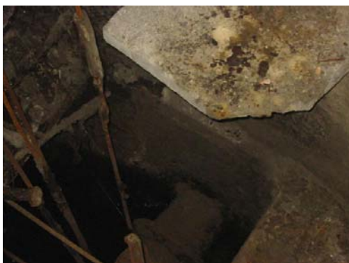
Руйнування колектора водопроводу м. Нововолинська унаслідок його підтоплення
