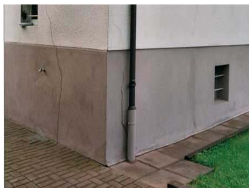
Утворення невеликих тріщин в будинках” унаслідок розвитку деформаційних процесів
