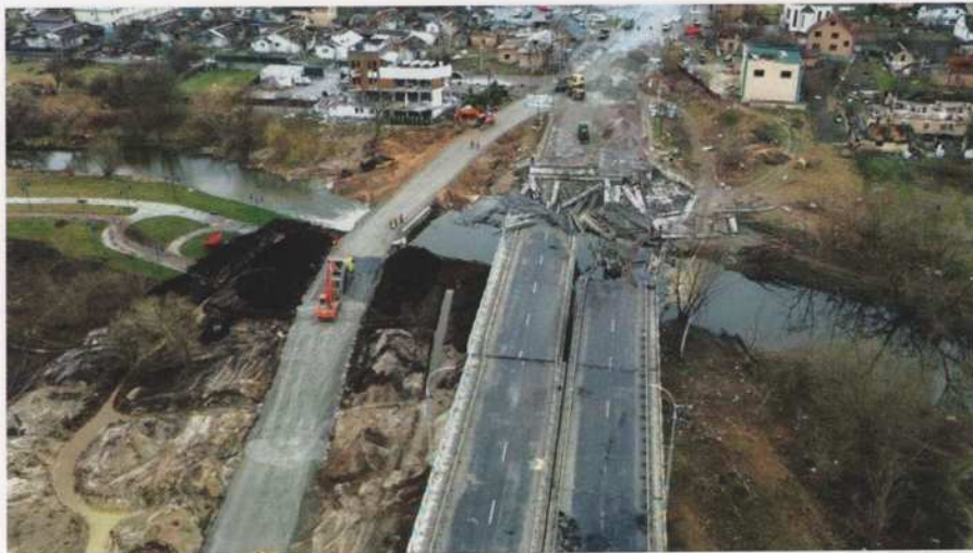
Po wycofaniu się Rosjan, Ukraińcy od razu przystąpili do odbudowy zniszczonej infrastruktury. Na zdjęciu tymczasowy most na trasie z Kijowa do Irpinu, który zastąpił trudną do szybkiej odbudowy stałą przeprawę / Zdjęcie: SG WSU
