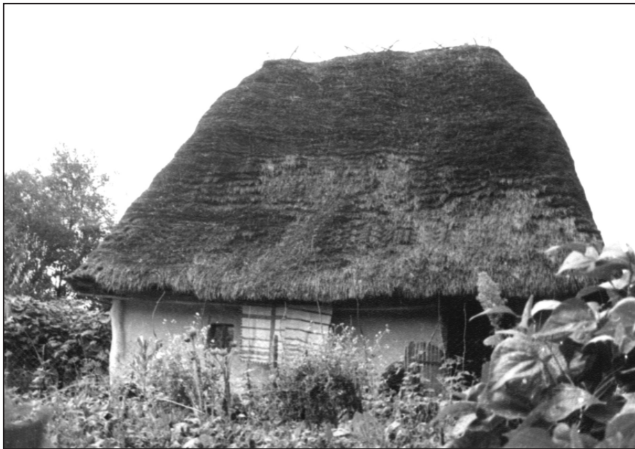
Хата початку XIX ст. з обмазаним і побіленим зрубом, чотирисхилим, вкритим слоною, дахом у селі Хижа Виноградівського району
