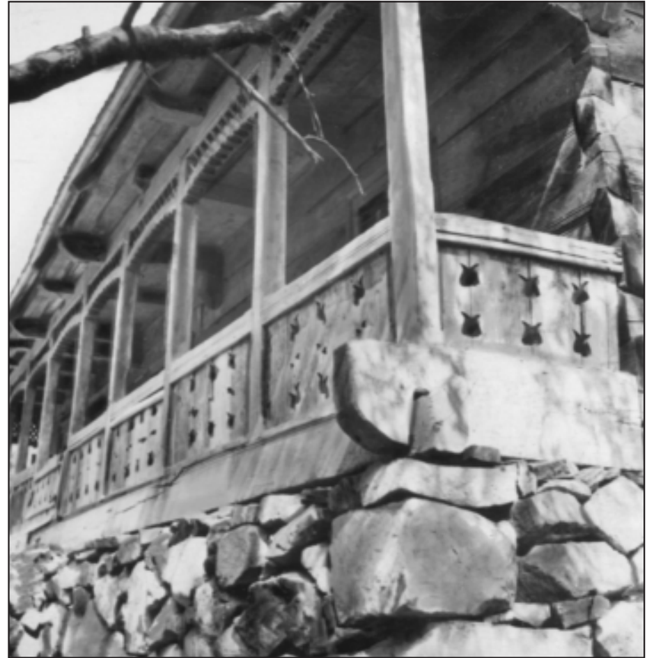
Напіввідкрита галерея хати 20-х років XX ст. у селі Середнє Водяне Рахівського району
