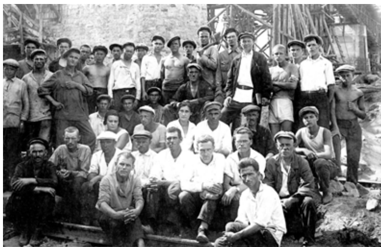
Ілюстрація 21. Бригада виконроба Рубана на будівництві моста аванкамери. Правий берег, 1930 р. (17846/ФН-2149)
