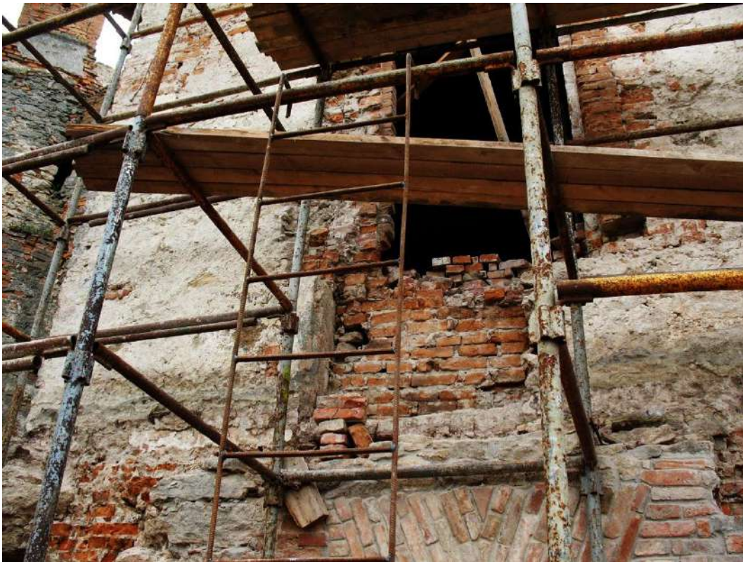
Рис. 16. Залишки дверного прорізу з вапняковим тесаним одвірком на рівні другого поверху.
